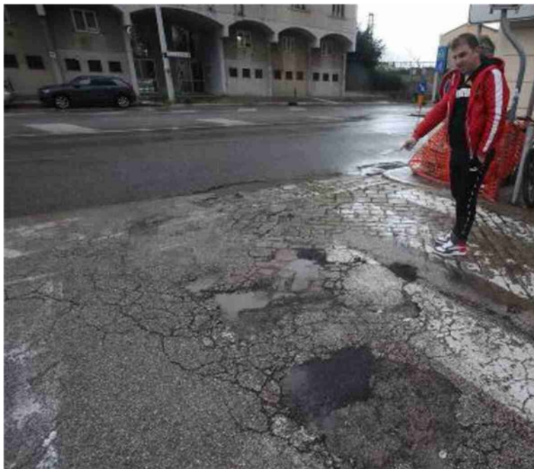
Il dissesto delle strade di Ancona al centro delle attenzioni dell'amministrazione
